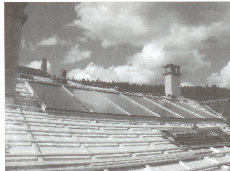
Installation solaire pour une maison
