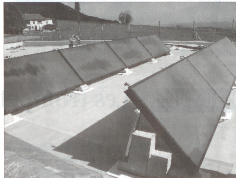
Exemple d'installation solaire industrielle réalisée par Sol-AIR Concept à Ballaigues.
